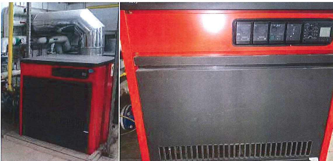
Rys.7. Rozmieszczenie kotła nr 1 (widok z lewej strony od wyjścia)
