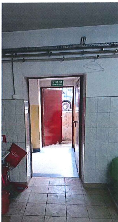
Rys.4. Widok wejść z pomieszczenia kotłowni
