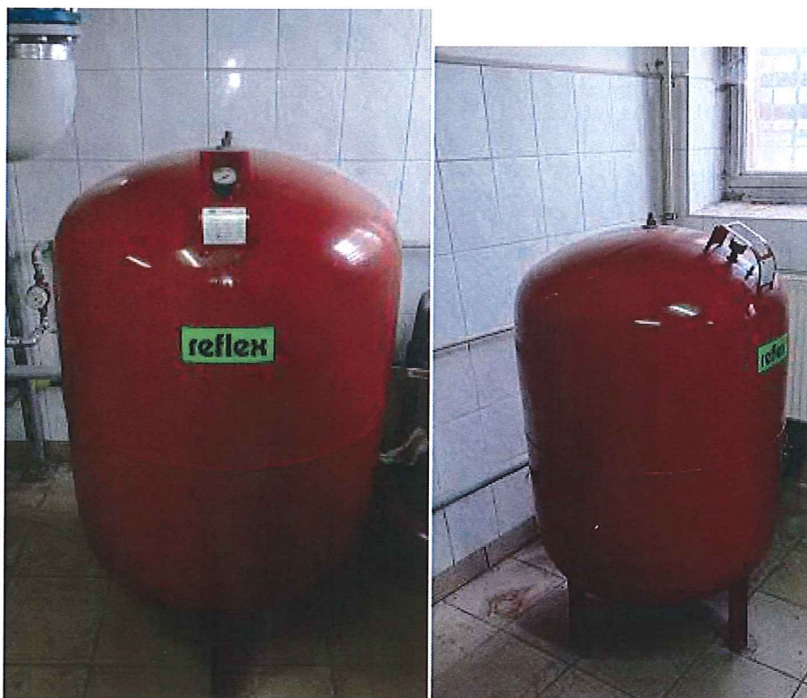
Rys.10. Widok stałego zbiornika ciśnieniowego
