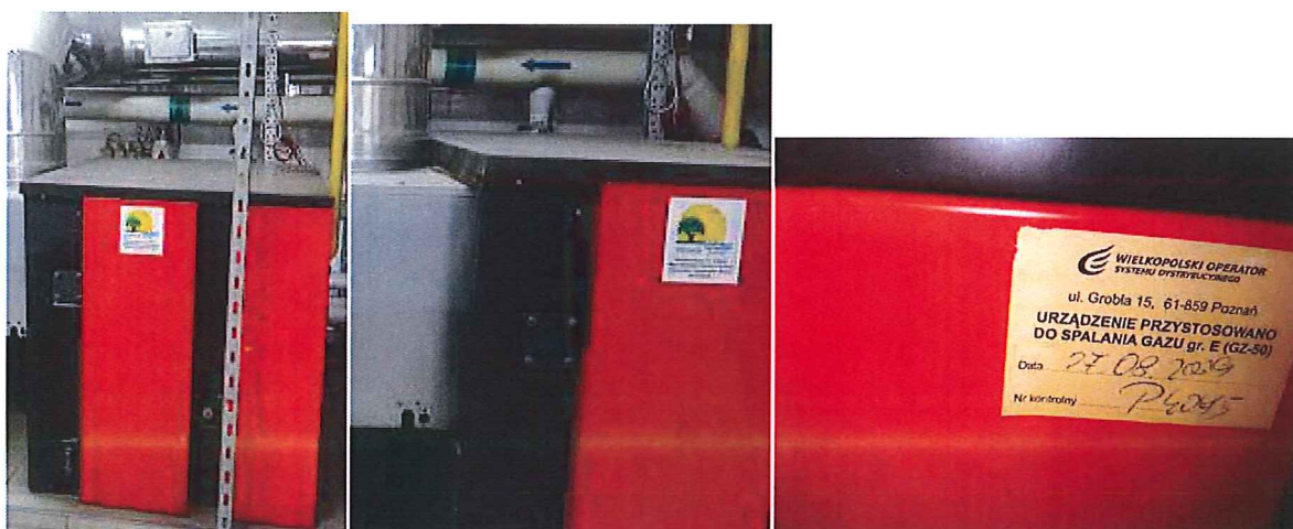
Rys.9. Rozmieszczenie kotła nr 2 (widok od strony okna)
