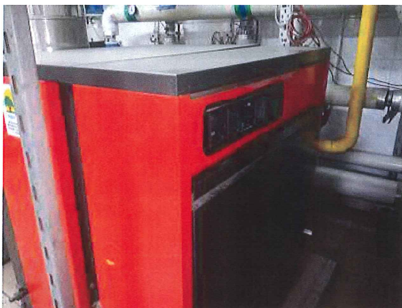
Rys.8. Rozmieszczenie kotła nr 2 (widok z prawej strony od ściany kotłowni)
