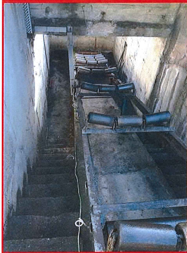
Rys. 2. Przenośnik nawęglania na zewnątrz budynku (bunkier)
