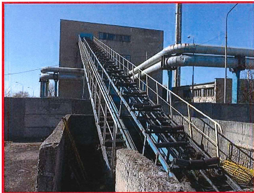
Rys. 3. Przenośnik nawęglania na zewnątrz budynku
