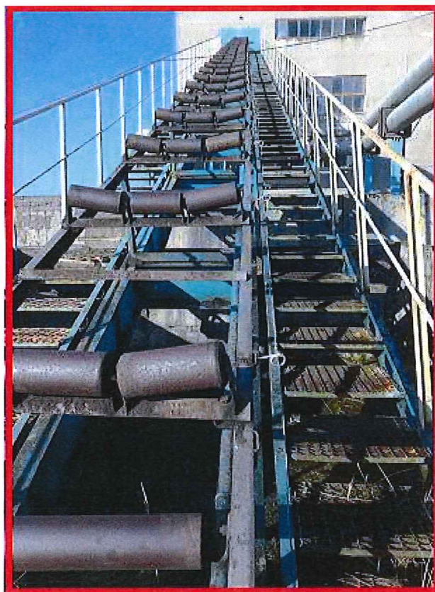
Rys. 1. Przenośnik nawęglania na zewnątrz budynku
