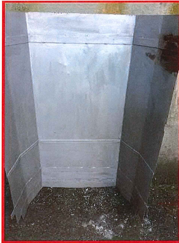
Rys. 4. Osłony przenośnika nawęglania na zewnątrz budynku
